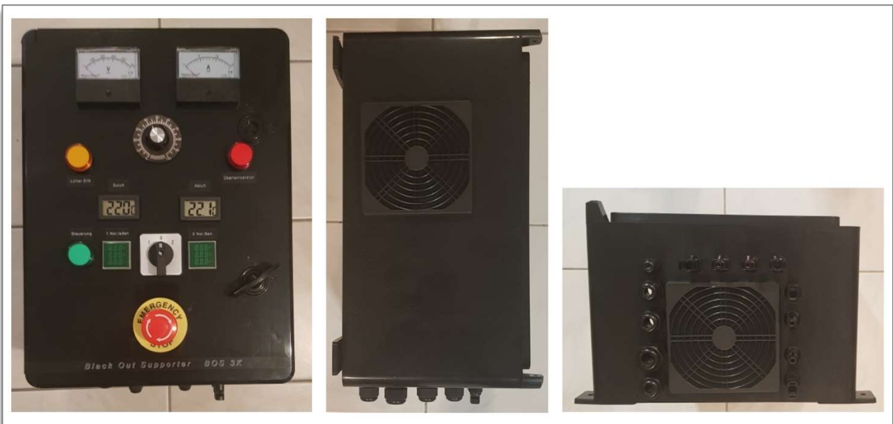
Verteilertür mit Einbauten
