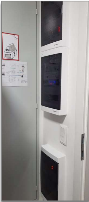
ZV / HV und SV 1-3 im Technikraum
