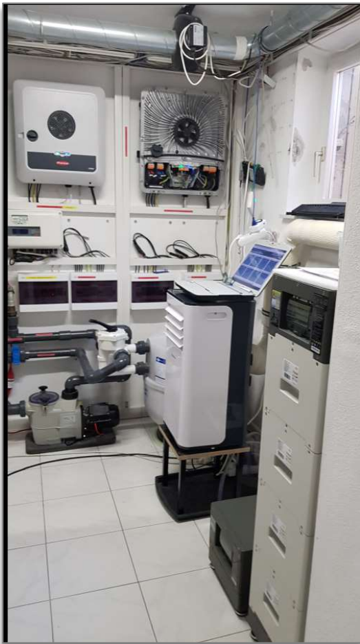
Puffer Speicher Raum KG mit Pool Technik, Klimatisierung
