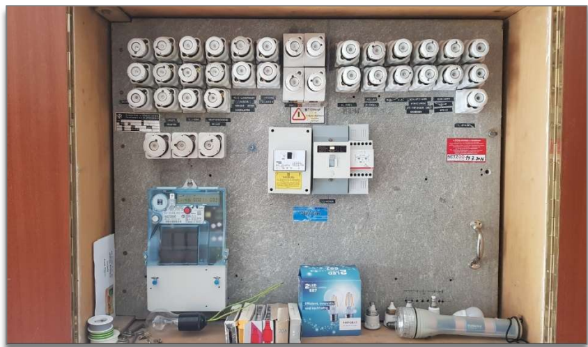
Bestand: Zähler- und Hauptverteiler
