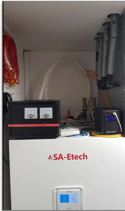
Black Out Supporter (BOS 480) über LWWP im Technikraum
